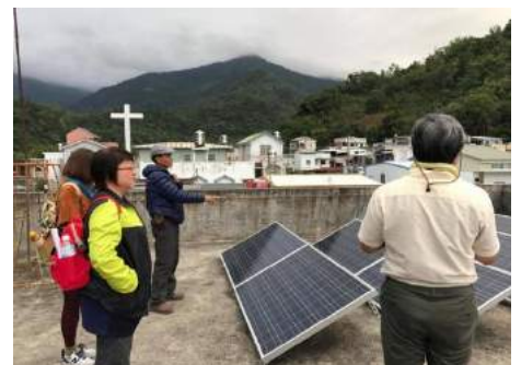
教会の屋上に作られた発電所
