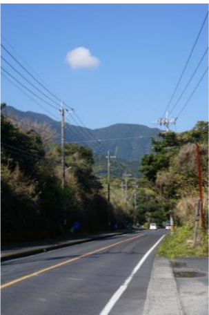
町と九電の配電線が平行する
